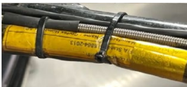
Figure 11 - Étiquetage des câbles de retenue
