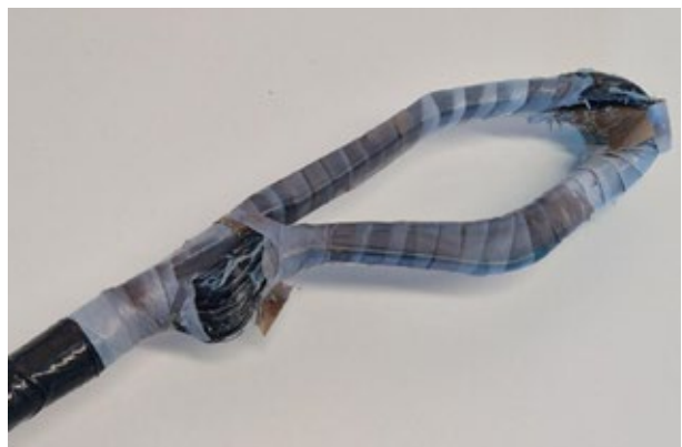
Figure 4 - Endommagement des fixations d'extrémité du câble de retenue
