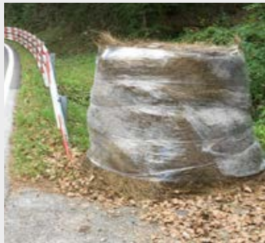
Extrémité de la glissière non protégée
