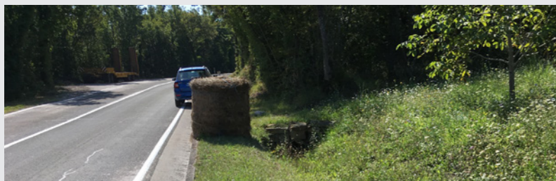
Système d'évacuation en béton non protégé
